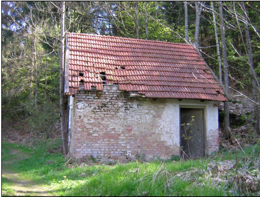
Ehem. Nebengebäude am Stauweiher. Baufällig.
