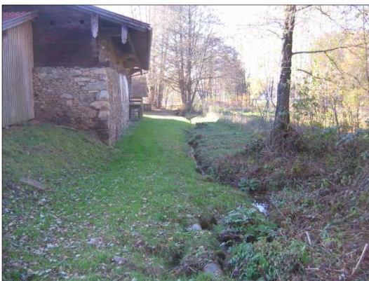
Abb. 9: Bestand des Dießenbaches im Bereich des Urberhofes, Aufnahme MKS Architekten – Ingenieure GmbH vom 31.10.2012
